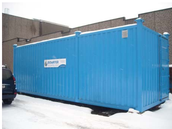
Containeren der prosessutstyret er installert
